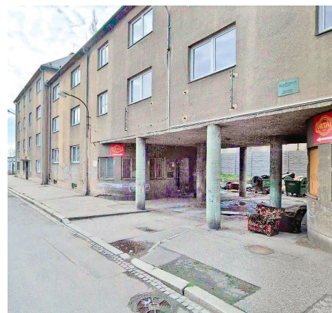
Stav domu před rekonstrukcí (foto: Seznam.cz)
