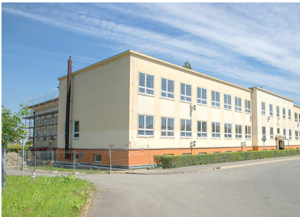
Hlavní budova odloučeného pracoviště Ibsenova 36 prochází celkovou rekonstrukcí. V době uzávěrky zde již byla vyměněna okna a připravovalo se zateplení objektu.
