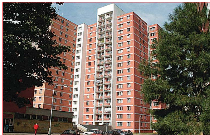
Sanace domu Maroldova I (vpravo foto 1) za 18 359 632 Kč: došlo k zabezpečení statiky objektu, provedeno zateplení stěn a střechy. Věžový dům má novou fasádu, střešní pláště a oplechování, opraveny jsou domovní vstupy i lodžie, dřevěná okna nahradila plastová.
